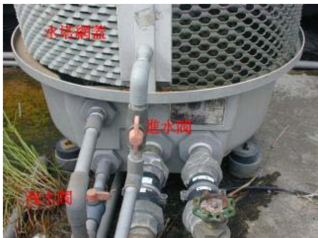
圖六 十三樓冷卻水塔(正面)
