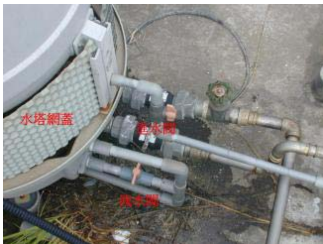
圖五 十三樓冷卻水塔(側面)
